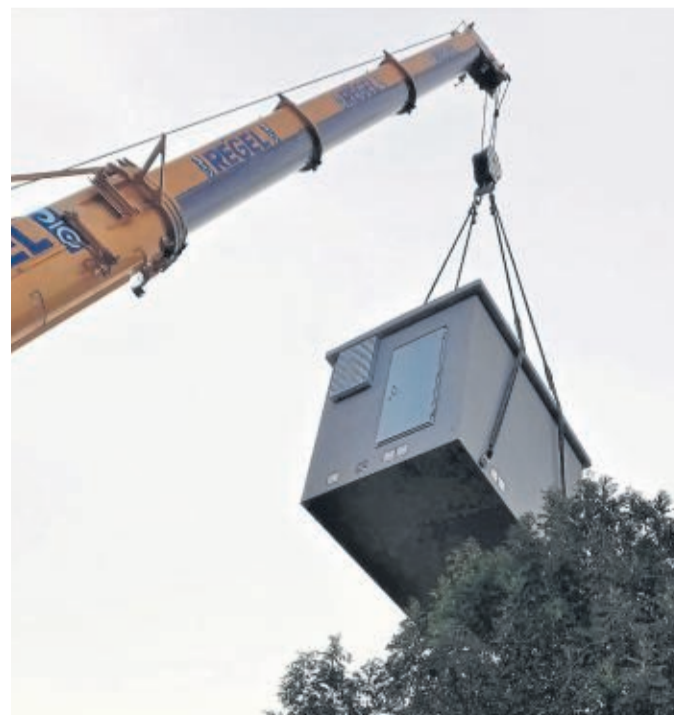
Das 22 Tonnen schwere Bauteil für den Glasfaserausbau wurde in Körle am Mittwoch angeliefert. FOTO: ATHANASIOS PSOMADOPOULOS
