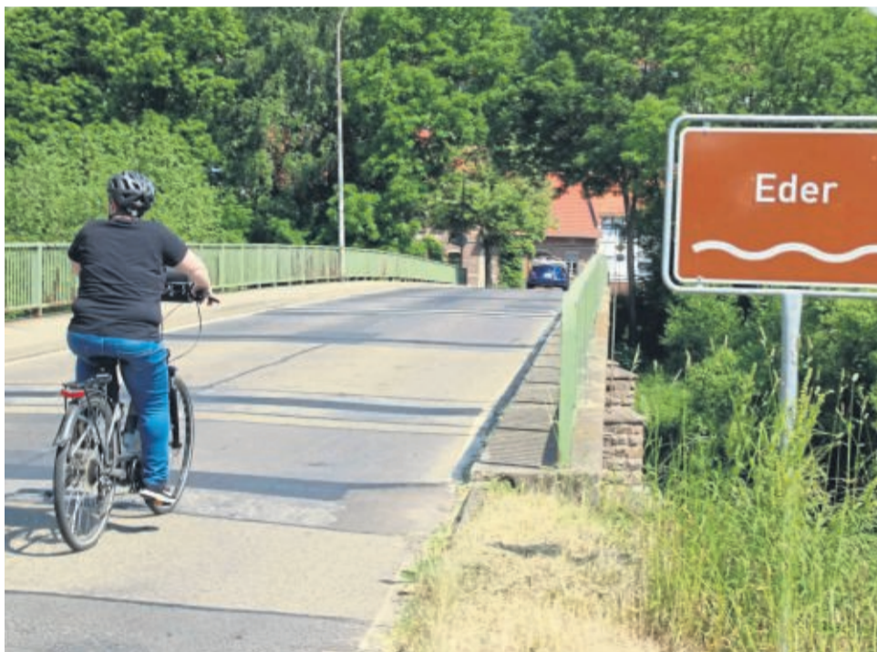
Die Ederbrücke in Brunslar hat nur einen Gehweg auf der flussabwärts gelegenen Seite. Die Brücke ist auf maximal 18 Tonnen Belastung zugelassen. Radler müssen die Fahrbahn benutzen.
